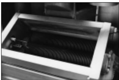
Figuur 3.1.2 Inspectie warmtewisselaar
